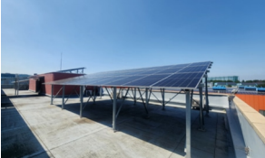
대동기어 태양광 발전설비
